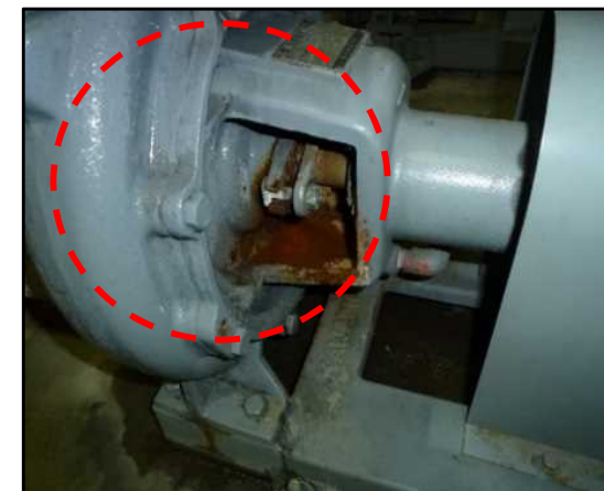
空調機器の破損
