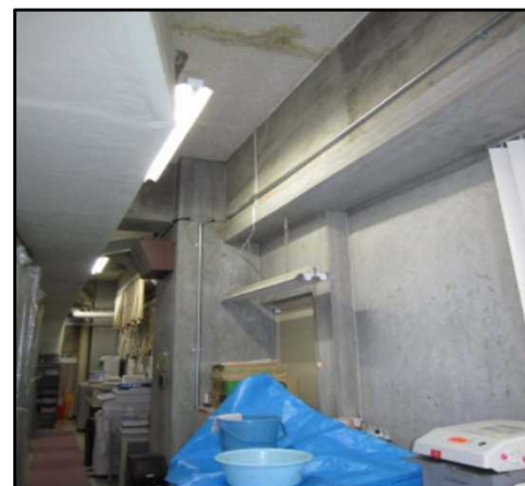
室内への漏水
