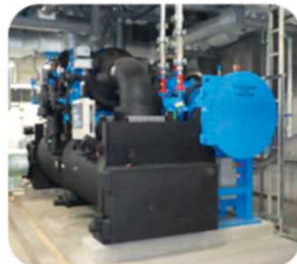
インバーターボ冷凍機
