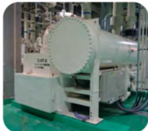
熱供給インバーターボ冷凍機
