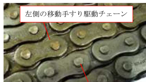
写真 I-2 移動手すり駆動チェーンの油の状態
