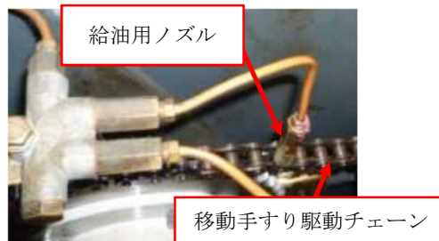
写真 I-8 給油機の給油用ノズル
