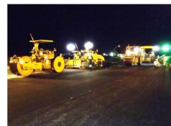
(老朽化した滑走路舗装の改良)
