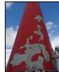
災害により損傷した灯台
