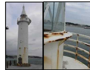
老朽化した灯台
