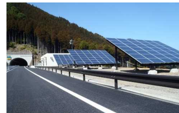
道路を活用した太陽光発電
