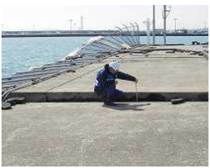
津波警報解除後の現地調査(陸上)
