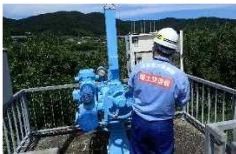
施設毎の操作となり、広域的な状態監視が出来ていない
