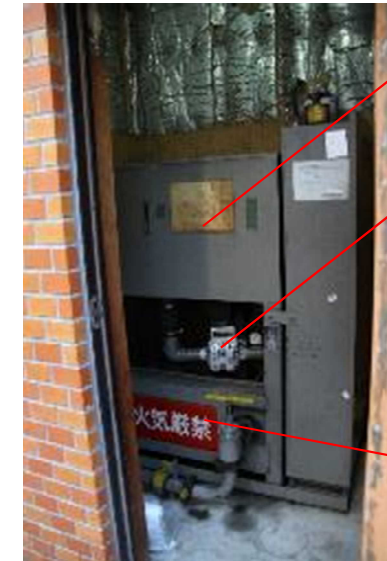
写真2 油圧パワーユニット
