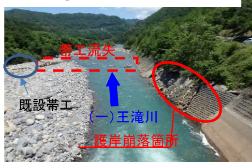
【写真② 下流帯工流失状況】
