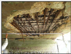
内部の鉄筋が露出した橋梁
