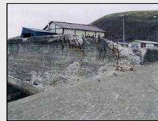
老朽化した海岸堤防
