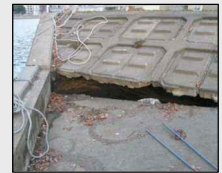
クラックが生じた河川護岸
