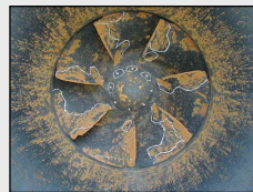
腐食した排水ポンプ場の羽根車
