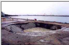
陥没した港湾施設のエロン
