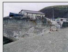
老朽化した海岸堤防
