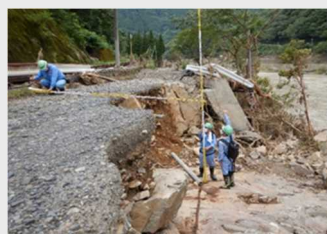
国道 219 号の被災状況調査 【熊本県球磨村】
