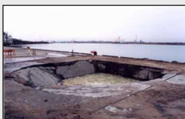
陥没した港湾施設のエロン
