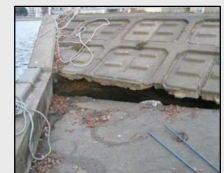
クラックが生じた河川護岸
