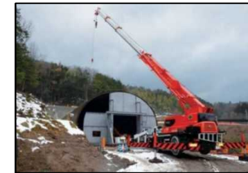
【防音扉設置状況】
