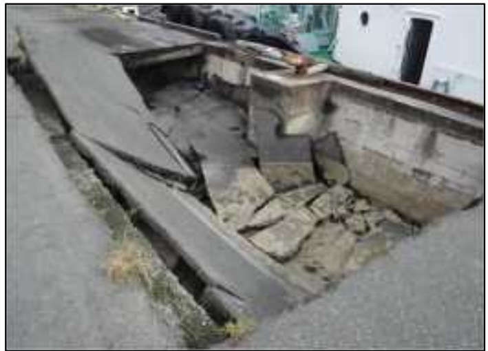
岸壁の背面土砂吸出しによる陥没事案
