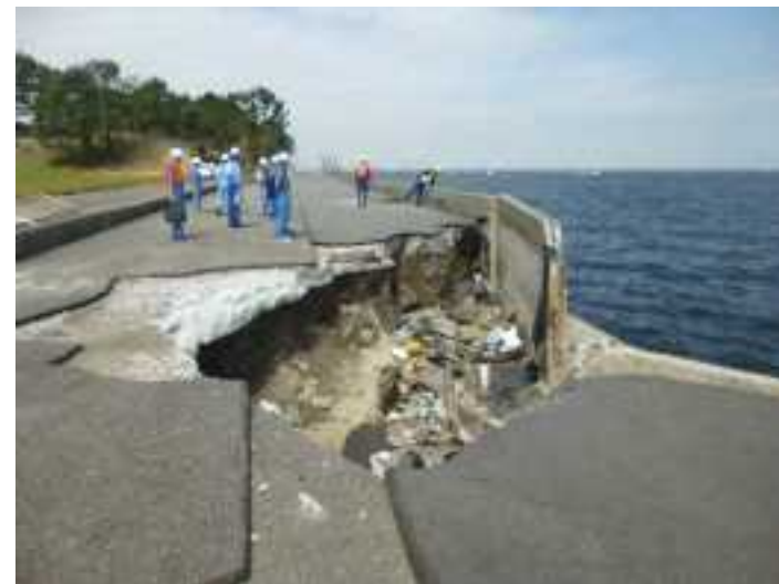
横浜港金沢区の護岸被災(横浜市)
