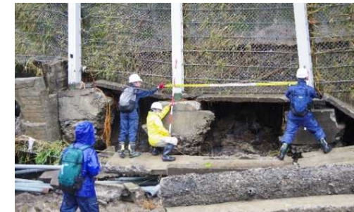
7月7日 道路法面の被災状況の調査 (熊本県球磨村)
