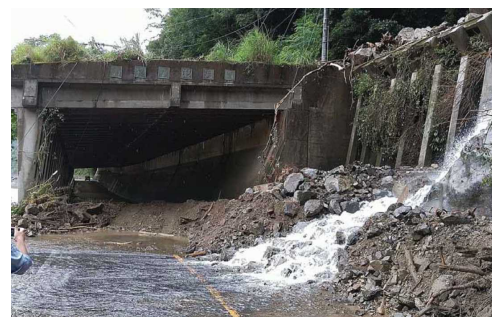
7月6日 国道219号の被災状況 (熊本県球磨村)
