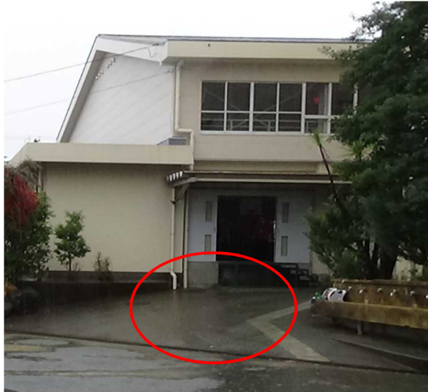
図表Ⅱ－３－１８ 荷役スペースの傾斜状況
