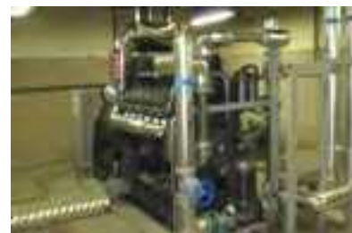
自家発電設備
