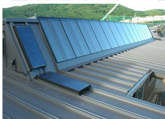
屋根上の集熱パネル
