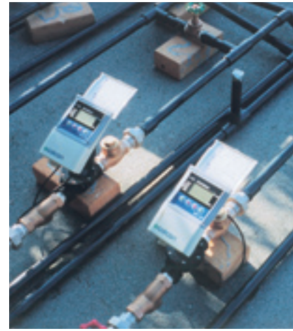
【自動灌水システムのコントローラー】灌水作業を軽減するため自動灌水システムが開発されています。
