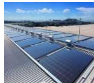
羽田空港・貨物ターミナル (国際線・2,000kW規模)
