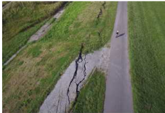
堤防の被災状況(亀裂)【9月6日】
