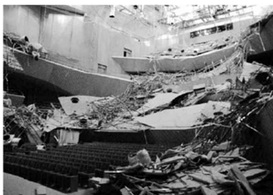
ホール天井の脱落
