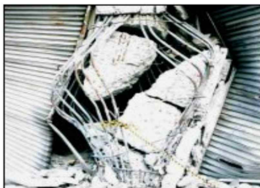
店舗1階柱の圧壊
