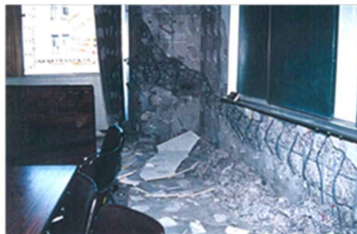
内部の被災状況
