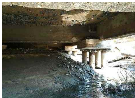
建物基礎が露出
