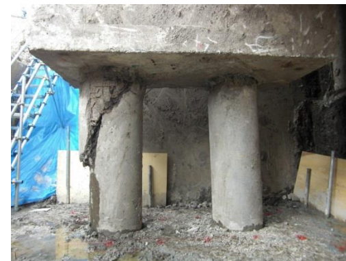
熊本地震での杭被害
