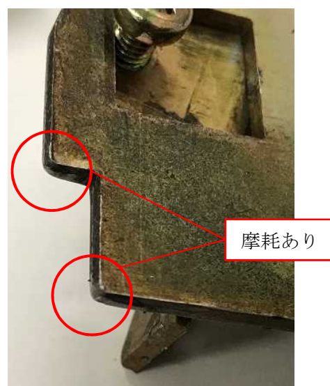
写真9 2階の可動ロック装置の係合部
