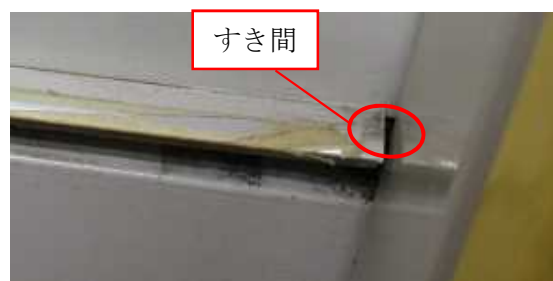
写真5 2階の出し入れ口右枠と持ち手のすき間
