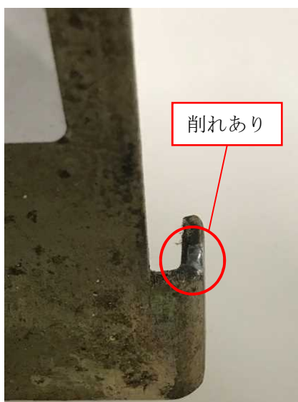
写真8 2階の固定ロック装置の係合部
