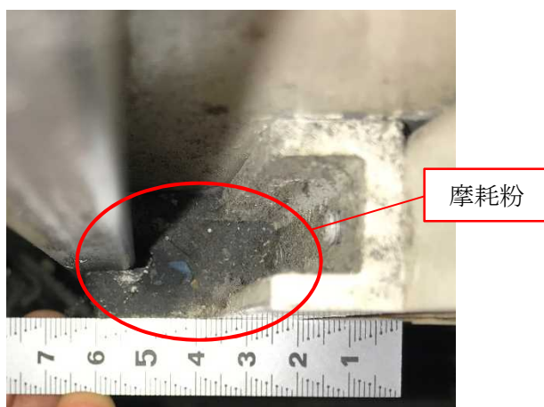
写真13 2階上側の戸下端のドアガイドシュー摩耗粉の堆積状況
