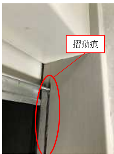
写真4 2階の出し入れ口右枠の摺動痕
