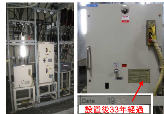
電気設備：開放型の受変電設備を使用しており、老朽化している
