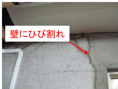
内壁：壁にひび割れが発生している
