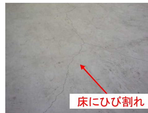
内部床：床に多数のひび割れの発生が見られる
