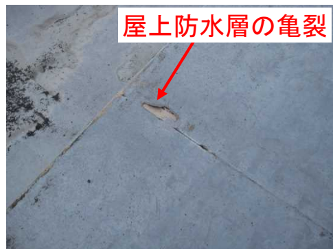
屋上：屋上防水の劣化が見られる
