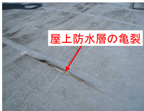
屋上：屋上防水の劣化が見られる
