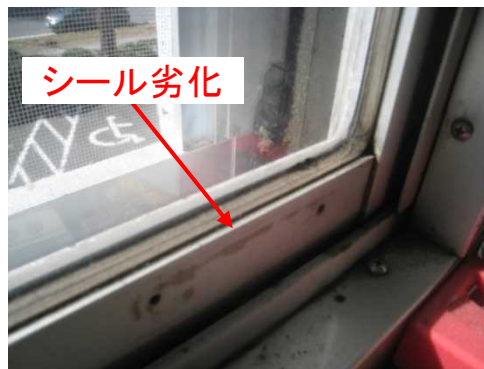
建具：アルミサッシの老朽化により作動不良が見られる
