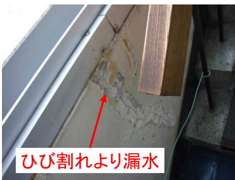
内壁：サッシ周り、ひび割れより漏水の発生が見られる
