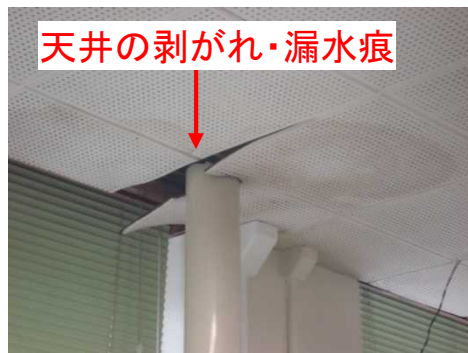
天井：漏水により天井の剥がれが発生している
