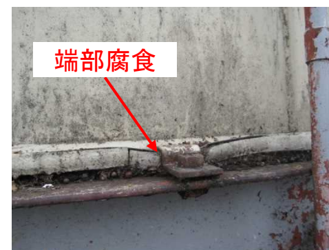
機械設備：高置水槽に著しい劣化が見られる
