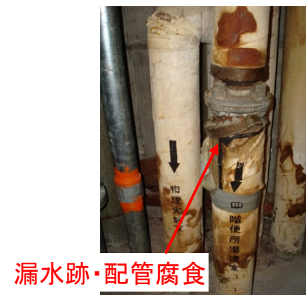
機械設備：排水管からの漏水及び腐食が見られる
