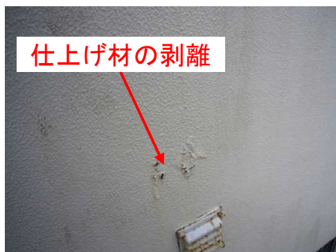
外壁：仕上げ材の劣化及び剥離が見られる
