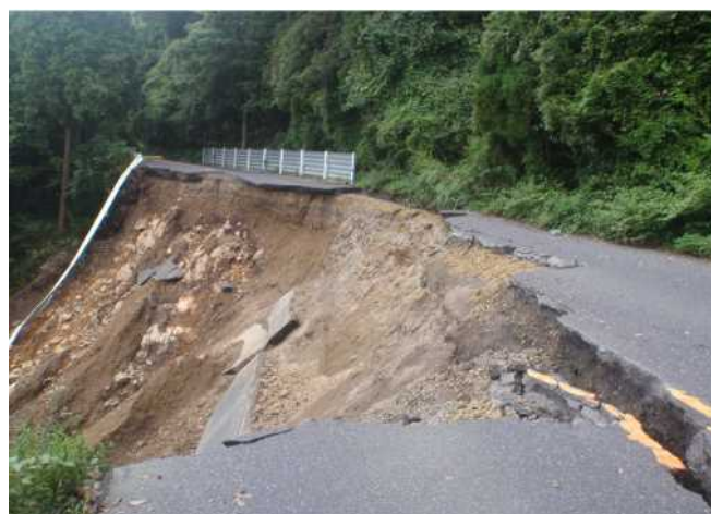
たにやまちゃん 主要地方道 谷山知覧線（鹿児島県鹿児島市） 道路崩壊
