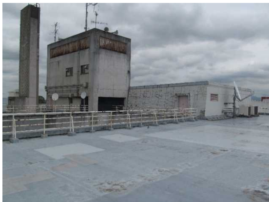
屋上の劣化（本庁舎）
