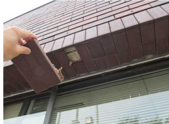
外壁タイルの落下（千代川庁舎）
