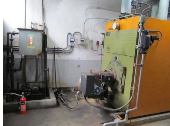
空調設備等（ボイラー）の老朽化（本庁舎）
