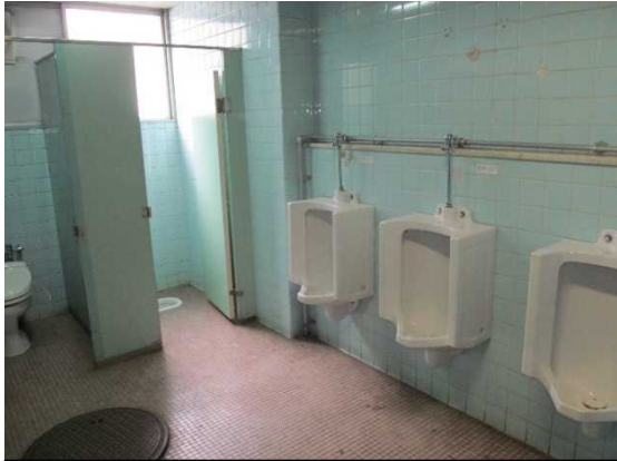
給排水設備等（トイレ）の老朽化（本庁舎）
