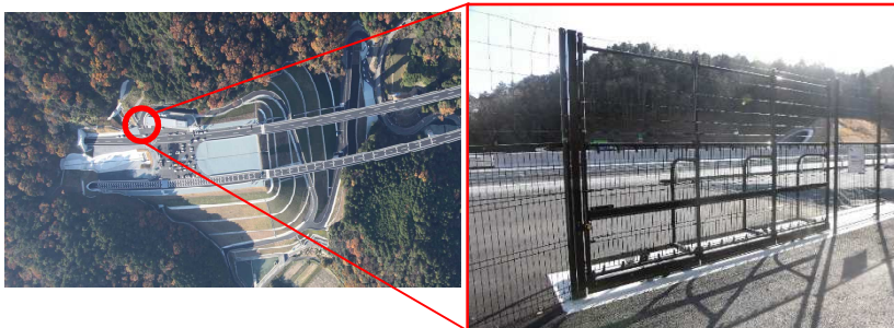
<緊急開口部設置の状況(新名神高速道路 箕面とどろみIC~茨城千提寺IC)>
