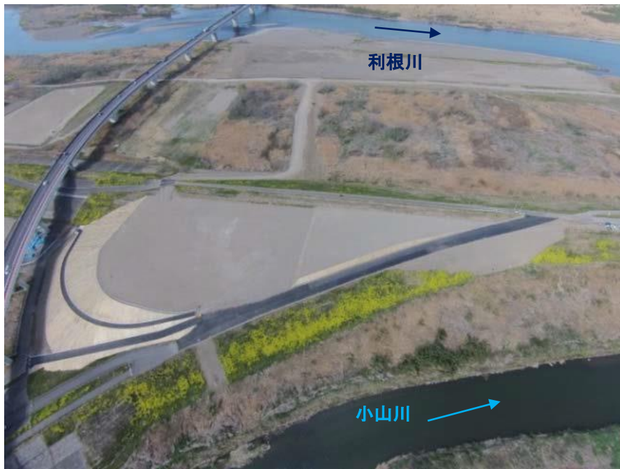
下高島地区(埼玉県深谷市)
