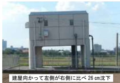
(a) 傾斜した RC 造ポンプ建屋
