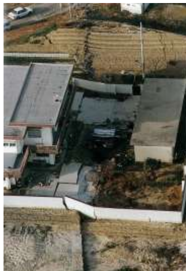
写真 i 建物の直近を地表断層が通るが建物は倒壊していない
