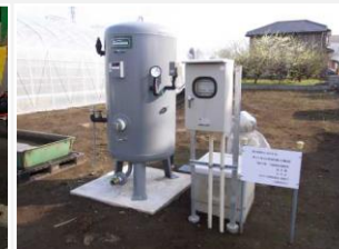
防災兼用井戸の整備
