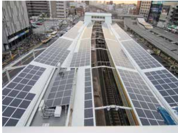
図表2-5-11 西船橋駅の太陽光発電システム
