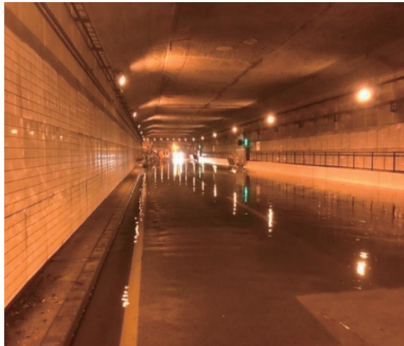
図表1-2-2-18 台風第21号による港島トンネルの冠水（神戸港）
