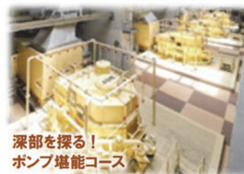
心臓部「ポンプ室」
