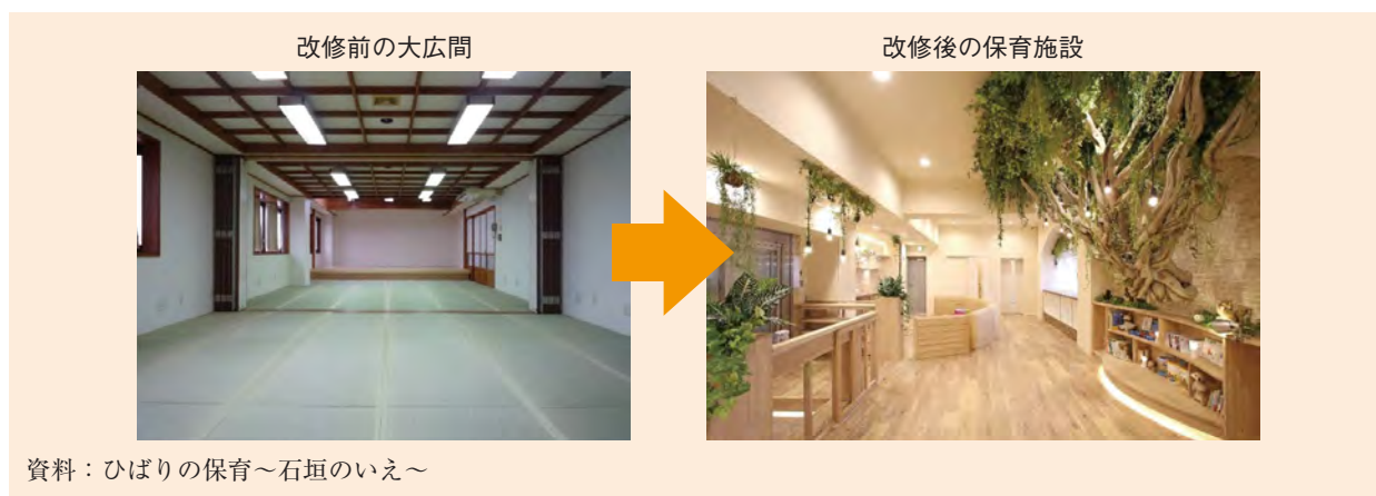
図表3-2-14 ホテルの大広間を改修した保育施設（沖縄県石垣市）
