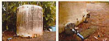
昭和47年に設置され、経年劣化により漏水が発生しているFRP水槽
