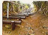
階段：降雨による洗掘
