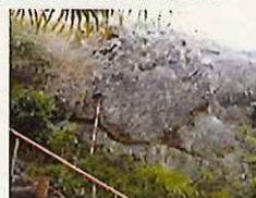
急傾斜地の落石危険箇所
