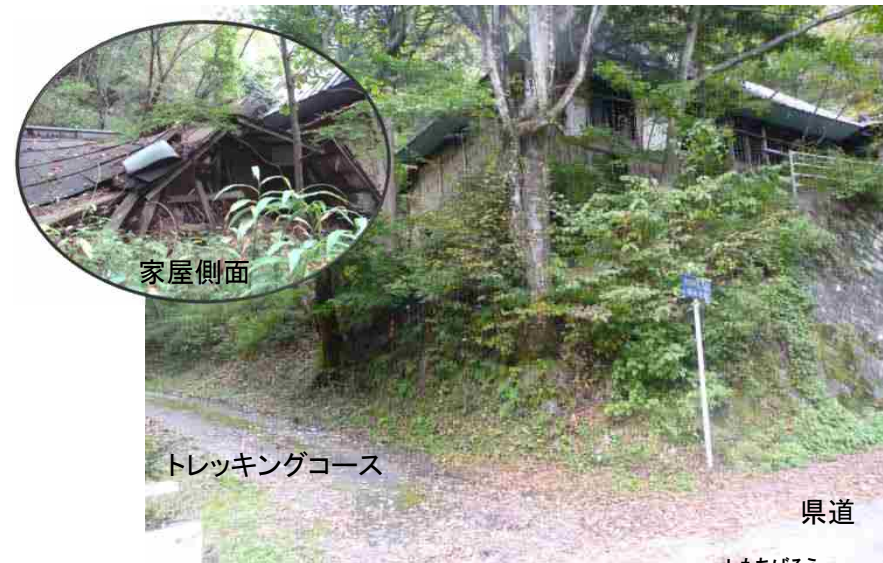
写真1:道路に隣接する荒廃空き家(下上籠)
