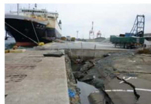
非耐震強化岸壁背後の陥没
