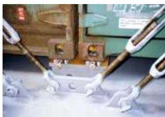
コンテナの流出防止対策（固縛設備）
