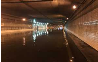
冠水するトンネル
