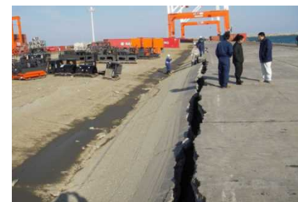
非耐震強化岸壁背後の陥没
