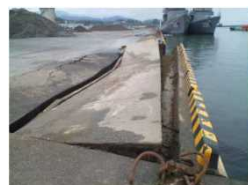
地震により被災する岸壁
