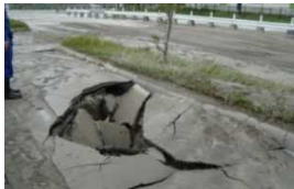
地震により液状化する臨港道路
