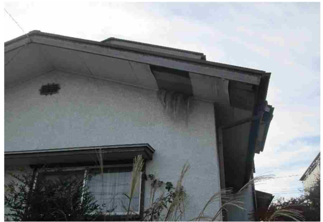
写真4：宅地所有者が不在で必要な管理が行われていない空き家（埼玉県鳩山町）
