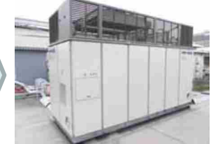
スマート発電システム
