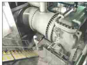
雨水ポンプ(広島市)
