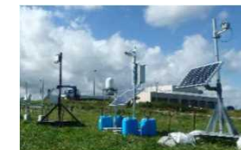
簡易型河川監視カメラ(現場実証の状況)
