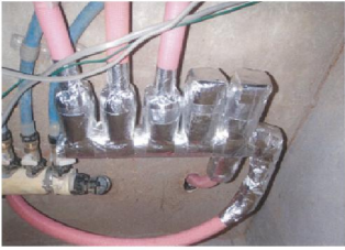
床下供給配管 二重管ヘッダー廻り 3P被覆PE配管完了 保温材仕上げ完了
