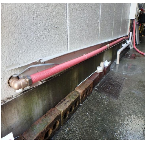
二重配管給湯先分岐システム二重配管
