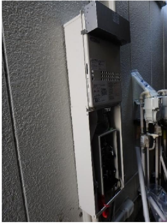
給湯器+二重配管循環ポンプユニット
