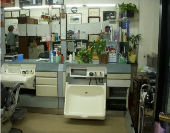
理容室既存洗髪器×4台
