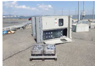
写真 2.2.4 屋外電気設備の被害
