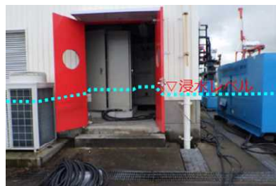
写真 2.2.3 現場変電所の浸水
