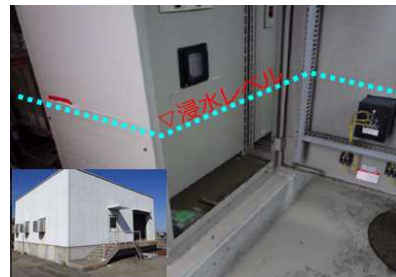
写真 2.2.2 現場変電所の浸水
