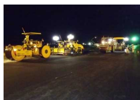
(老朽化した滑走路舗装の改良)
