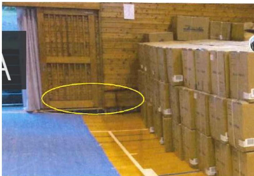
図表 III-2-1 支援物資を大量に保管したため床が損壊した体育館（平成 28 年熊本地震）
