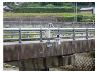
現場実装された危機管理型水位計
