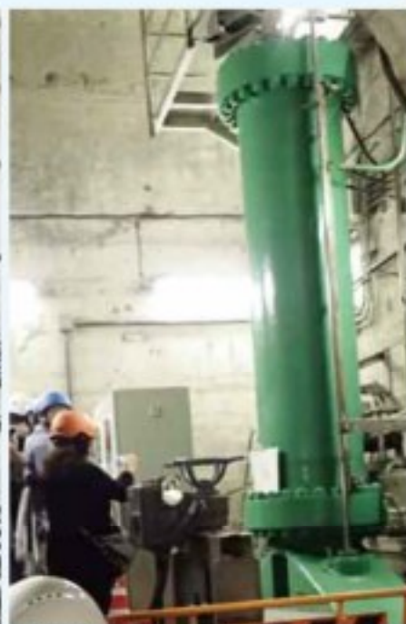
五十里ダムの堤体内部にある国産第一号の 高圧スライドゲート
