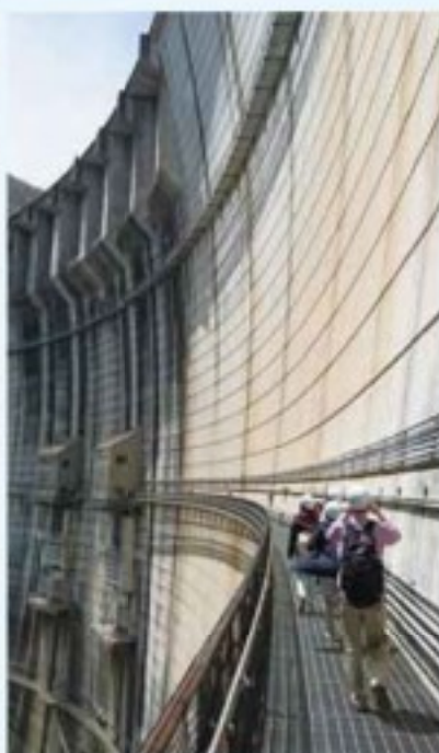
民間ツアーの目玉としている川治ダムの キャットウォークの見学
