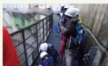
管理用の柵では隙間が大きく危険なため網フェンスで対応
