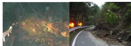
写真1 国道152号被災状況
