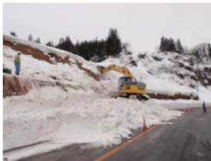
写真2 斜面雪処理による片側交互通行規制状況
