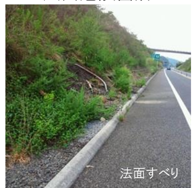
《法面危険箇所》
