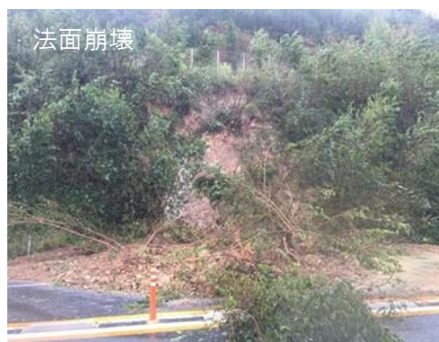
被災年月日:平成29年10月22日 通行止め:2日間
