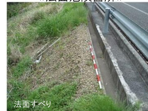
《法面危険箇所》
