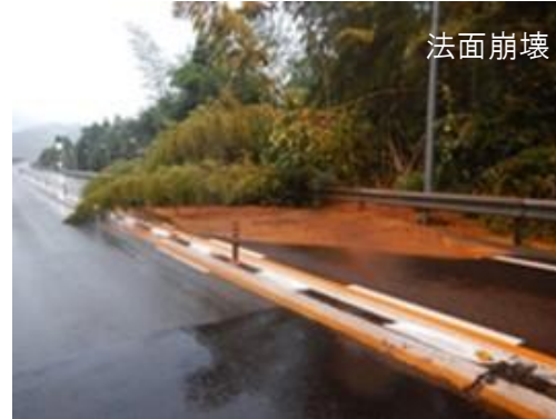
被災年月日:平成16年10月21日 通行止め:2日間
