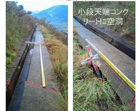
《法面危険箇所》
